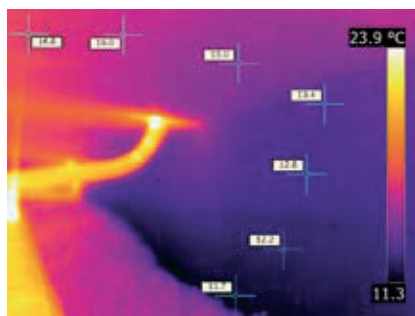
Infraroodfoto van de onderkant van de vloer tussen de fundering en het kussen.
